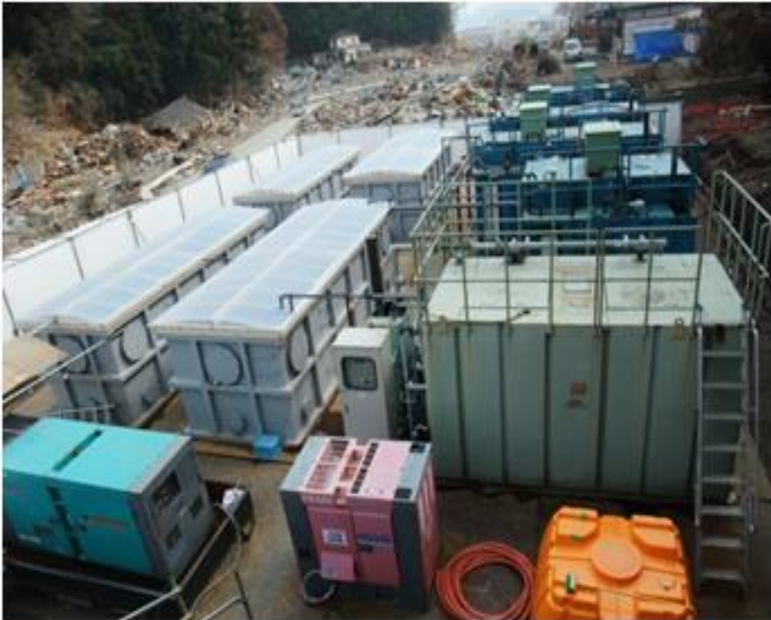
陸前高田ユニット型膜処理システム（H23.4.28稼働開始）
