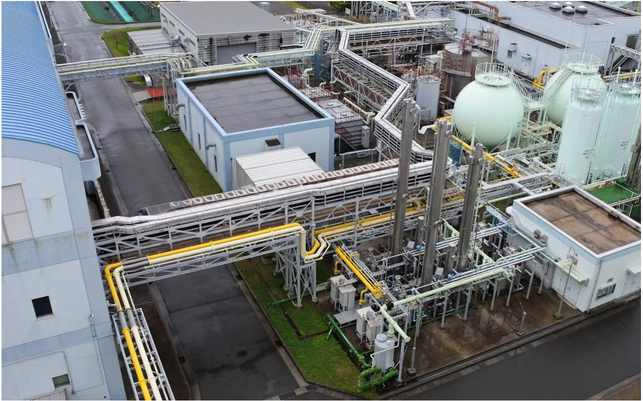
下水由来のバイオメタンを天然ガスと同等のメタン濃度まで高める（神戸市の東灘処理場）
